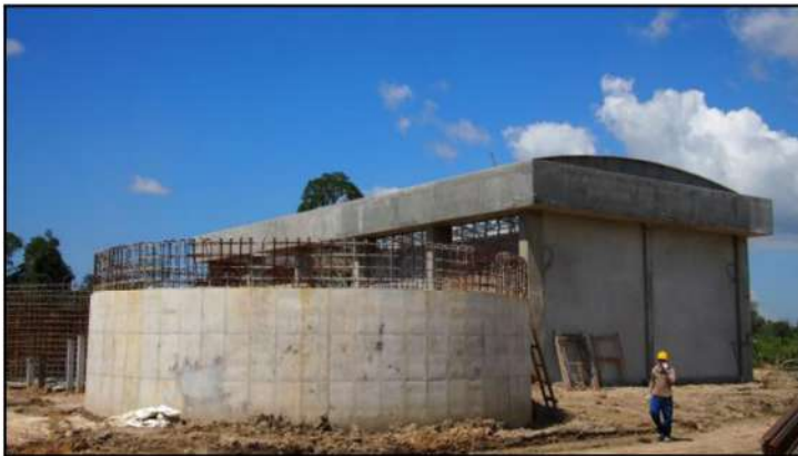
Water Treatment Plant (Bukit Barun)
